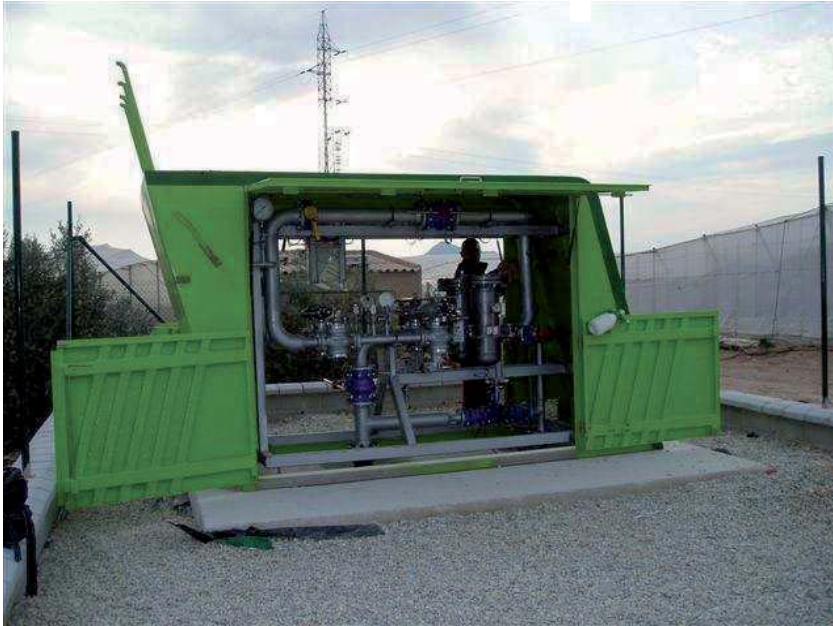
Caseta de ERM de distribución en San Javier, Murcia. Marzo 2006.
