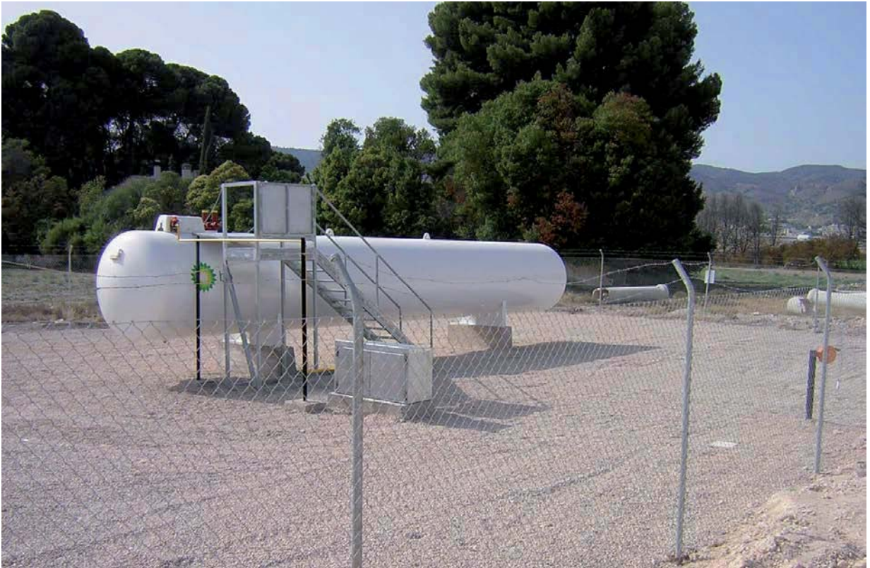
Planta de GLP de Castalla, Alicante. Julio 2005.
