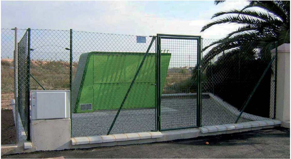
Caseta de ERM de distribución en San Pedro del Pinatar, Murcia. Diciembre 2005.
