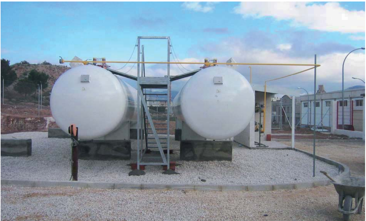
Planta de GLP de Sax, Alicante, noviembre 2003.
