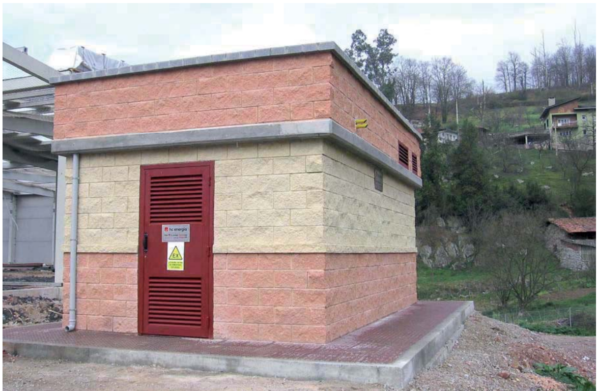
Caseta de ERM de distribución en Argame, Asturias, febrero 2008.
