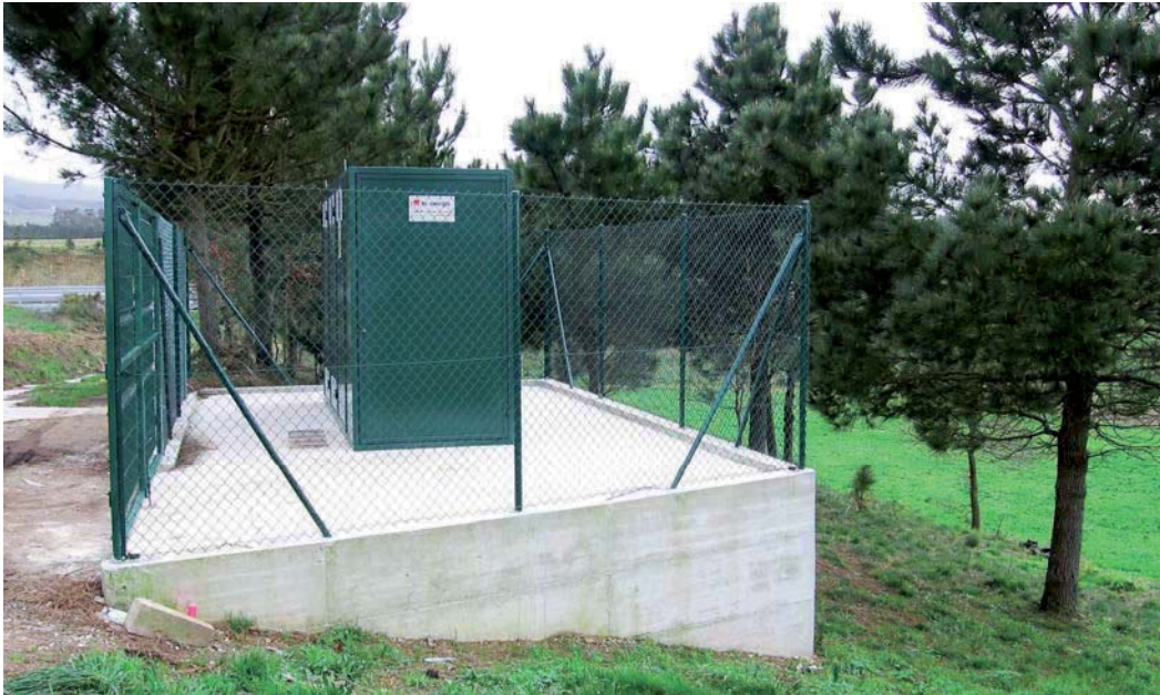
Caseta de ERM de distribución en Serantes, Asturias, febrero 2009.
